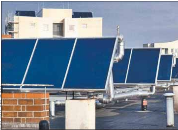
Fot. 1. Standardowe baterie słoneczne na dachu budynku mieszkalnego
